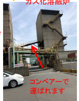
ガス化溶融炉
